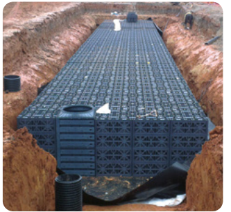
Bassins de rétention enterré SAUL
